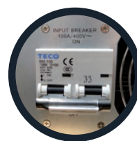
Breaker de entrada
